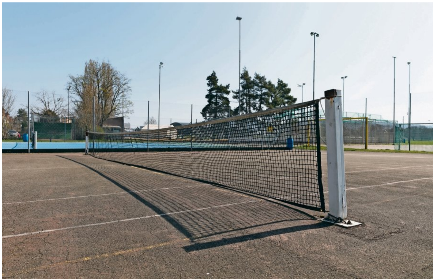
Der Platz mit Asphaltbelag weist deutliche Risse auf. Trotzdem wird er laut dem Sportamt noch regelmässig genutzt.
